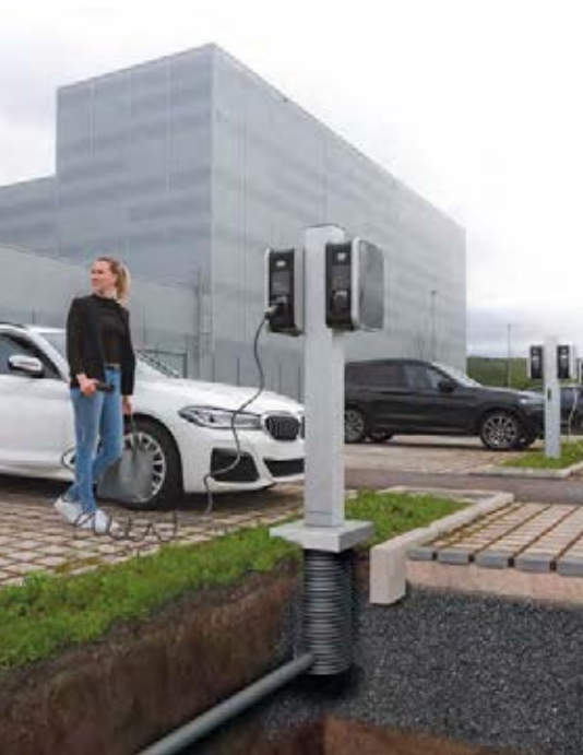
Ladeinfrastruktur für Park- und Stellflächen – einfach und schnell errichtet
