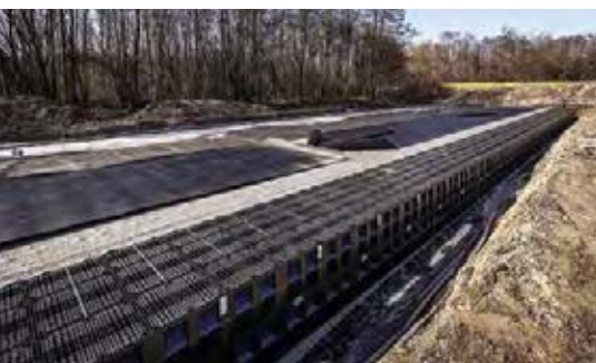
Regenwasserrückhaltung im Neubaugebiet in Leipzig
