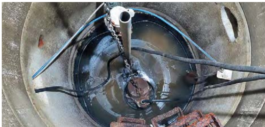
Schwefelwasserstoff (H 2 S) im Abwassersystem lässt Pumpen und Armaturen korrodieren
