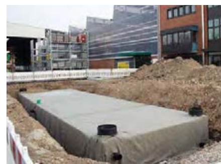
In einem dritten Arbeitsschritt wurde die Rigole nochmals mit dem Geotextil umschlossen und anschließend verfüllt
