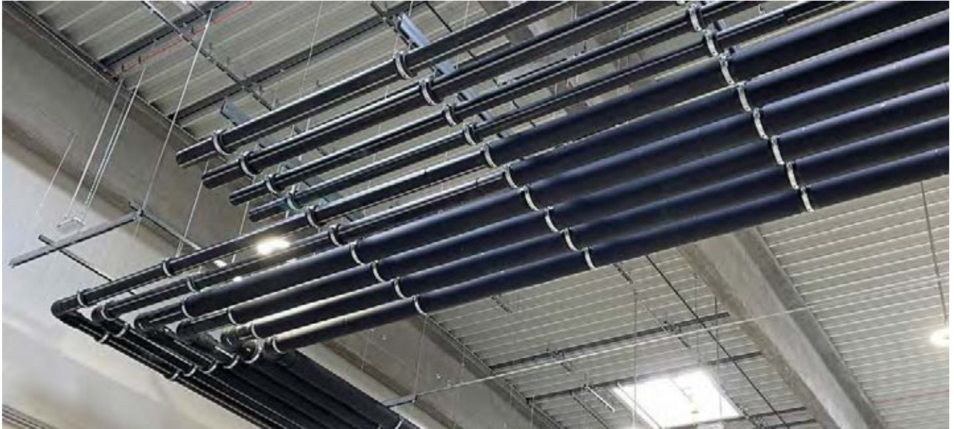
Freiverlegte Kühlleitungen in Fertigungshalle
