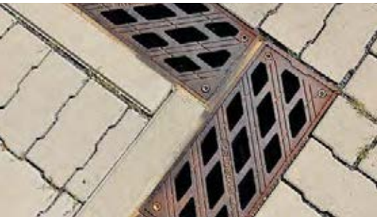
Entwässerungsrinne HYDROblock am Betriebshof Havelberg
